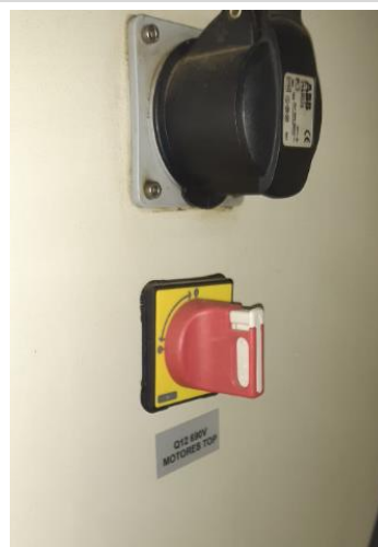
Seccionador Q12 en condiciones de operación. Q12 isolator in operation condition.
