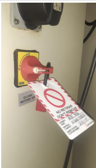
Instalación del candado en Q12. Padlock installed in Q12.
